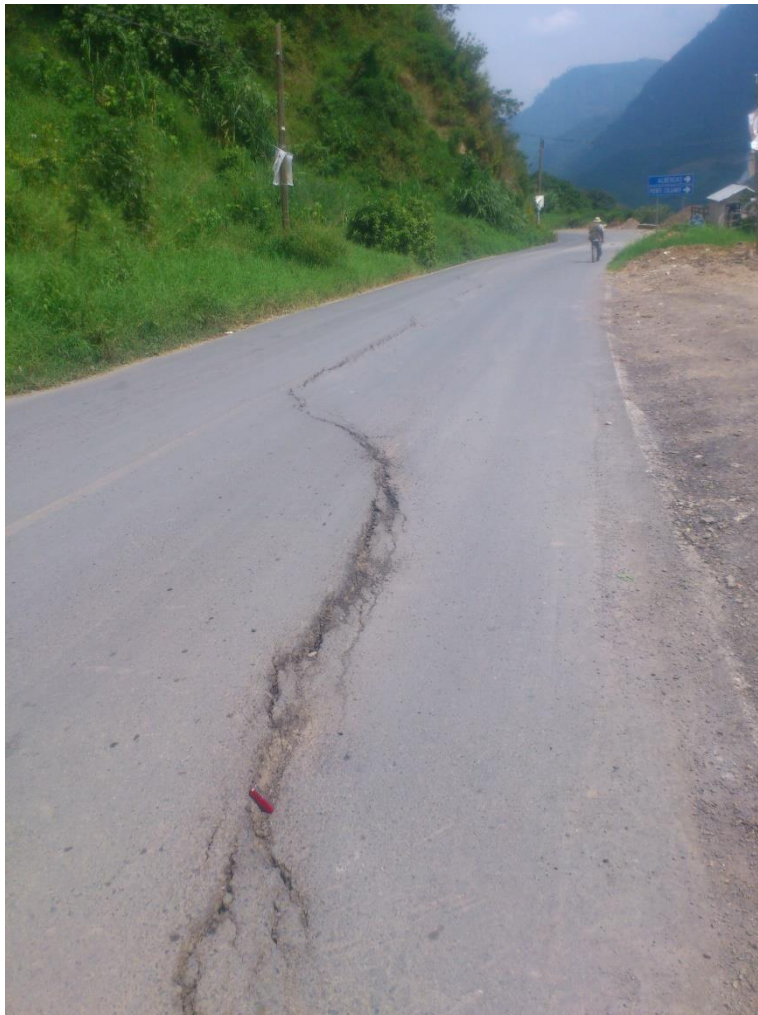
Imagen V.9. Agrietamiento o corona de deslizamiento o flujo., identificado en la carretera hacia Pahuatlán-San Pablito
