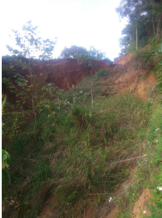
Imagen V.3. Deslizamiento menor al norte de Pahuatlán.
