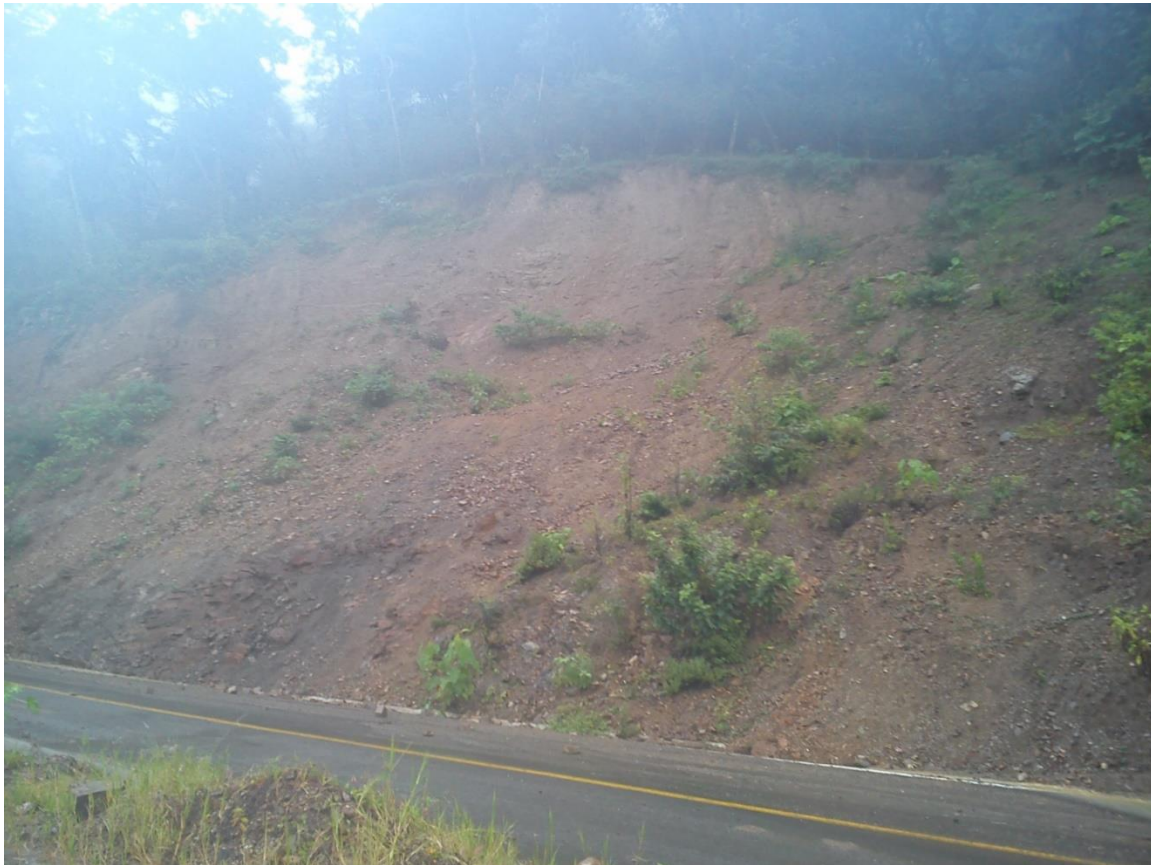
Imagen V.7. Ladera con proceso de derrumbes.
