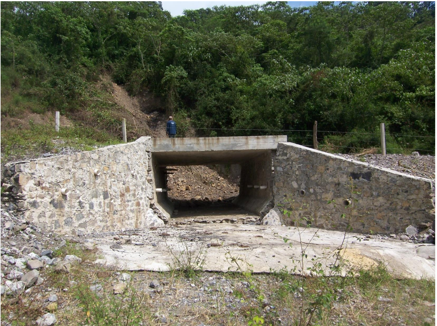
Imagen V.5. Flujo de tierra ocurrido al lado de un puente dañando la estructura del mismo.
