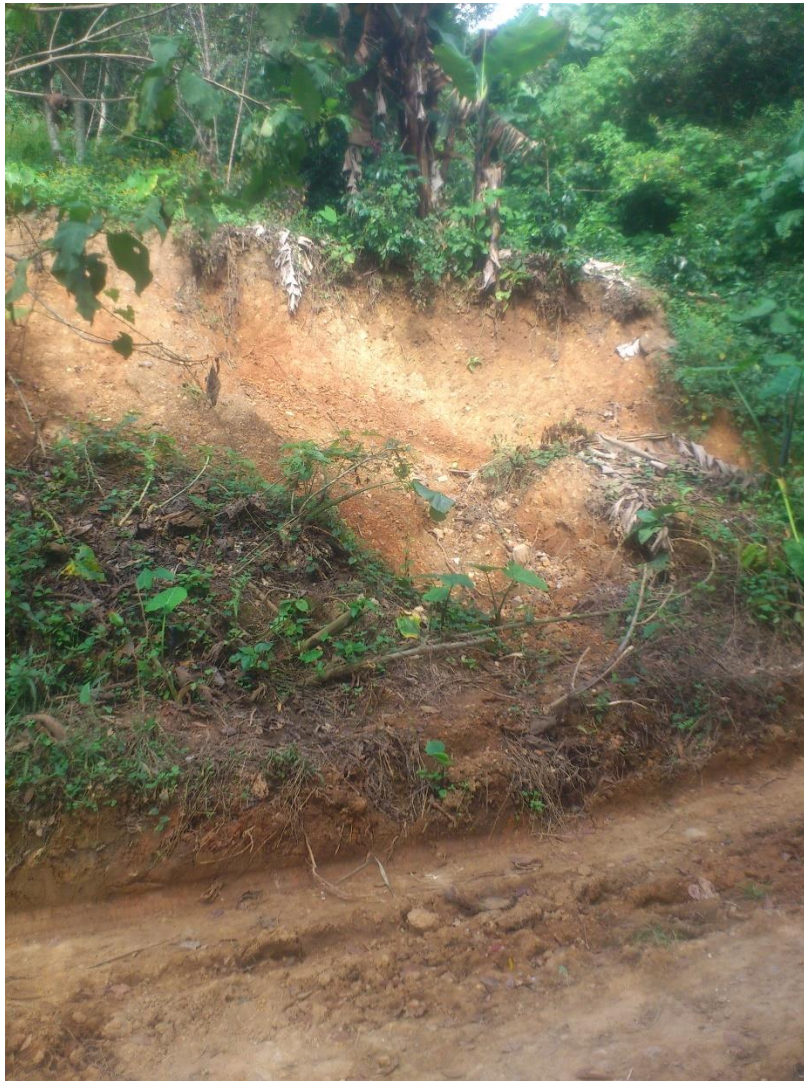
Imagen V.4. Deslizamiento desarrollado en una ladera de poca altura con materiales altamente intemperizados al lado de un camino de terracería.
